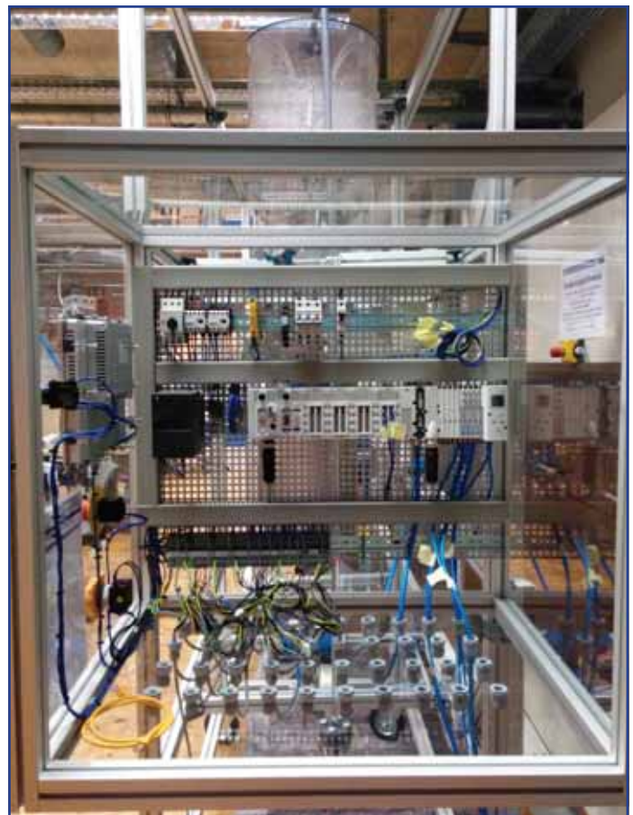
Bild 2: Eine von mehreren Steuerungseinheiten der Anlage im Aufbau
